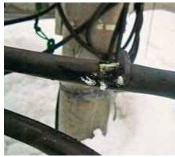
制御線損傷(左写真の拡大)
