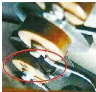
焼損した機器(ZPC)
