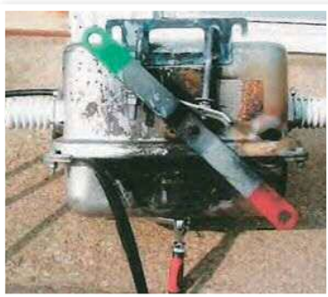
噴出した煤(開閉器側面)
