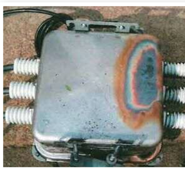
熱による変色(開閉器上部)
