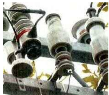
損傷した避雷器
