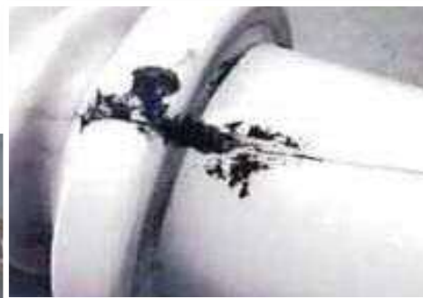
ブッシング破損状況
