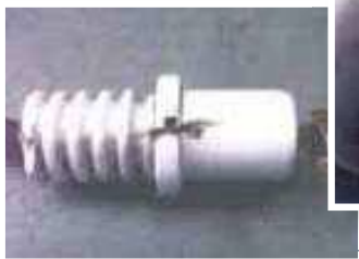
R相ブッシング(電源側)
