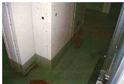
電気室浸水状況
