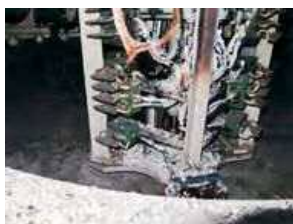
焼損した機械内部
