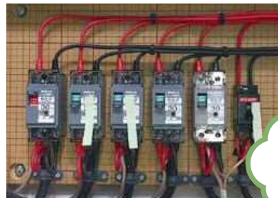
△分電盤内の様子
