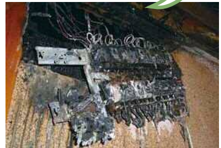
△分電盤内の火災事例
