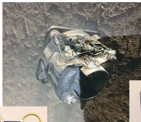
端子部分が溶けた 電流計切替器 (裏面)
