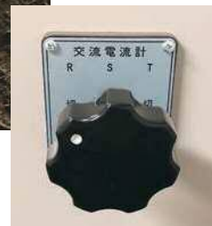
正常な電流計切替器 (正面)
