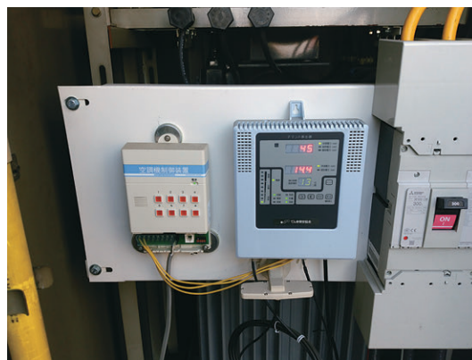
デマンド監視装置
