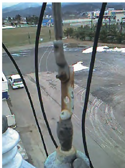
錆びた屋外ケーブル端末
