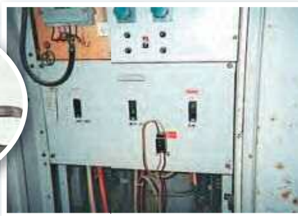
保護装置の電源ブレーカー
