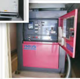
非常用発電機で停電時の 電源確保の強化を図る
