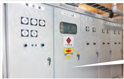
高圧受電設備(外観)
