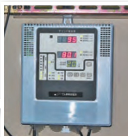
デマンド監視装置の設置状況
