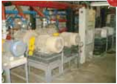
制御している真空ポンプ
