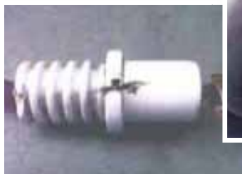
R相ブッシング(電源側)
