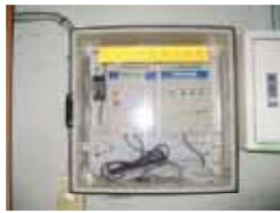
デマンド監視装置の設置状況
