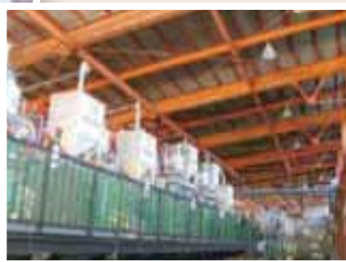
水銀灯など負荷制御を行っている成形室
