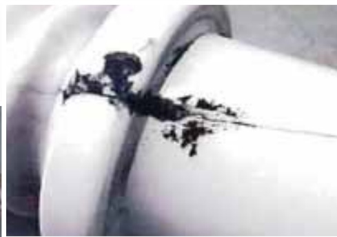
ブッシング破損状況
