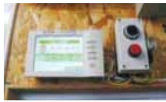
現場事務所の監視モニター (モニター本体のブザー音が小さいため、ブザーを増設しています。)
