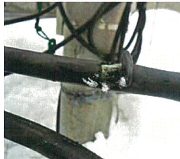
制御線損傷(左写真の拡大)
