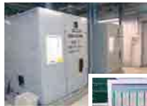
制御する 冷温水発生機
