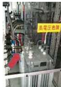
接触した変圧器
