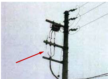
焼損したケーブル
