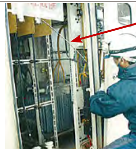
倒れたロック棒(上部)
