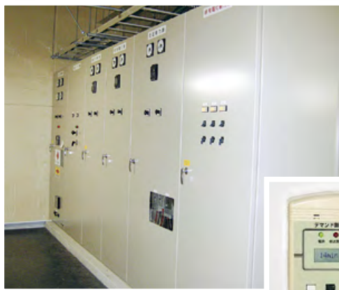
高圧受電設備
