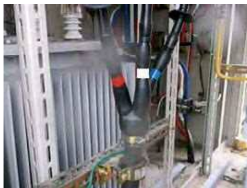
膨張した高圧ケーブル三又分岐管
