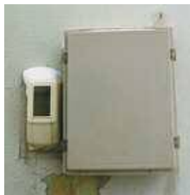
引込開閉器のボックスの外観
