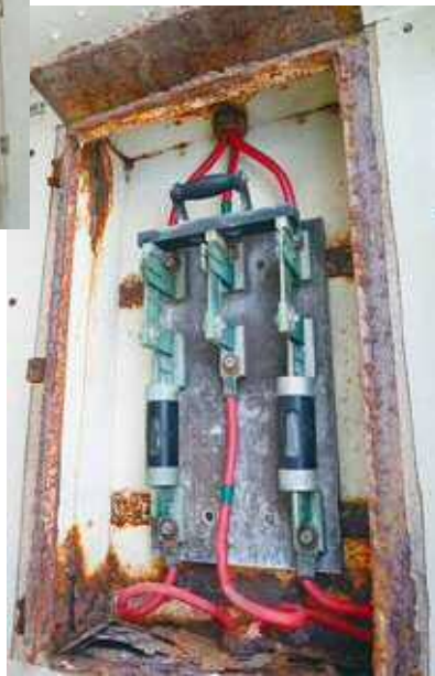
変色し、錆と腐食が進んでいる ボックスの内部
