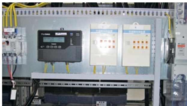
デマンド検出器(左)と空調制御装置2台
