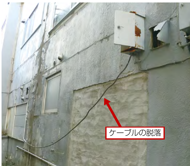
屋側配線の様子
