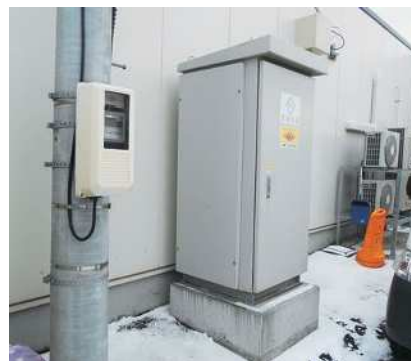
補修後のキュービクル
