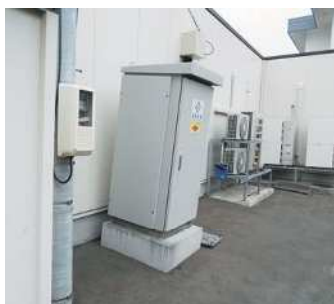
傾いた キュービクル
