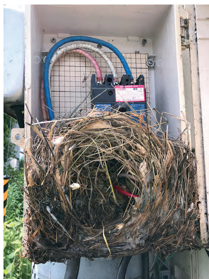
分電盤内のようなす
