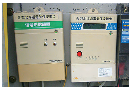
デマンド監視装置
