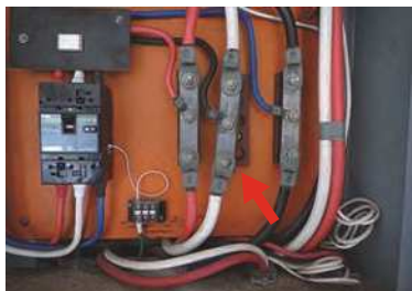
端子台の破損
