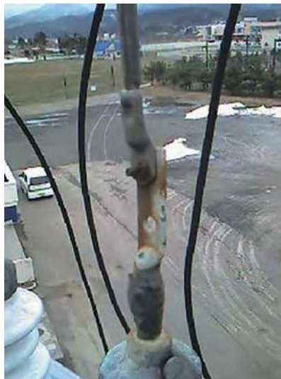
錆びた屋外ケーブル端末
