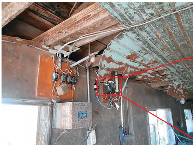
崩れ落ちていた天井内板
