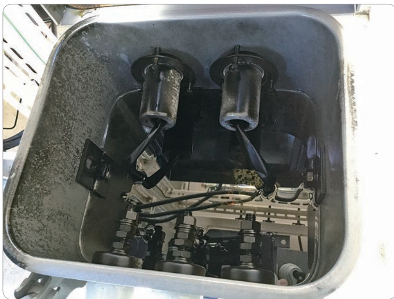
変圧器内部の焼損
