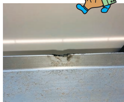
アルミフレームの損傷
