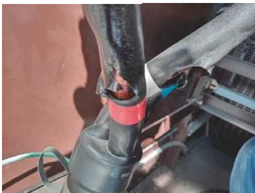
▼損傷したケーブル端末
