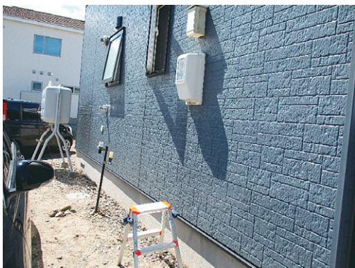
▼ 引込開閉器の設置状況
