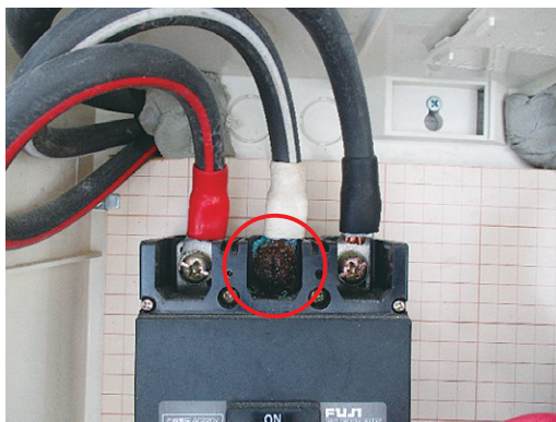
▼引込開閉器内開閉器端子の不良状況
