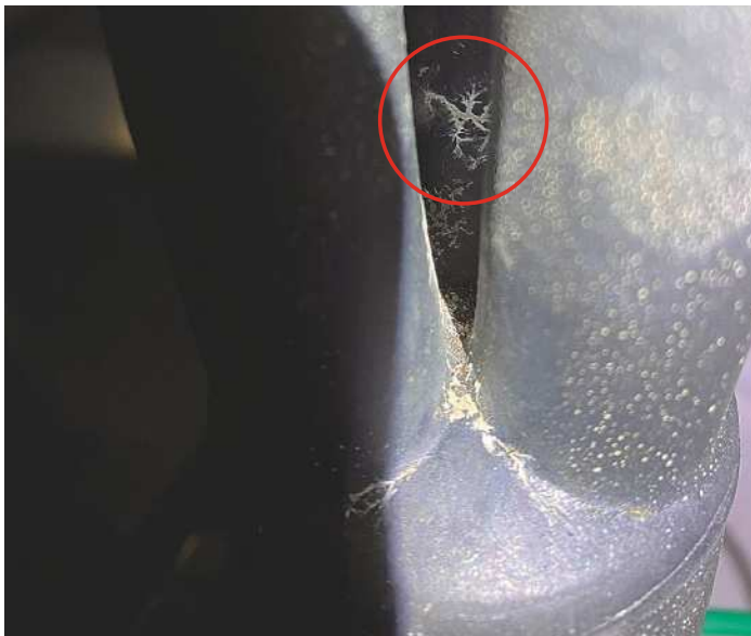
▼高圧ケーブル(リーク跡)
