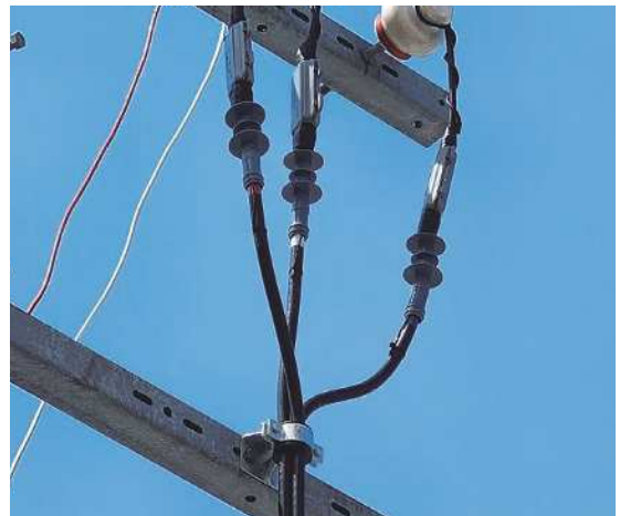
▼高圧ケーブル(交換後)
