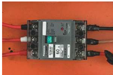
▼ブレーカ(交換後)
