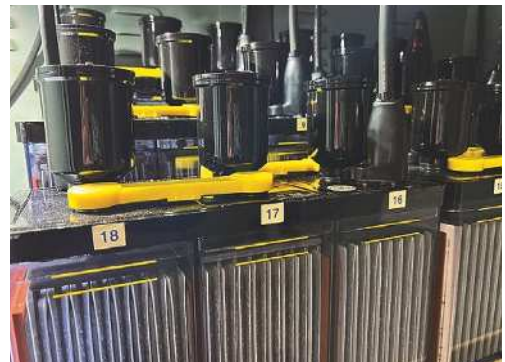
▼蓄電池(交換後)
